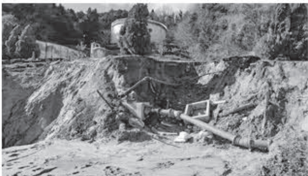
七尾市・岩屋浄水場内の配管損傷（提供：名古屋市上下水道局）
