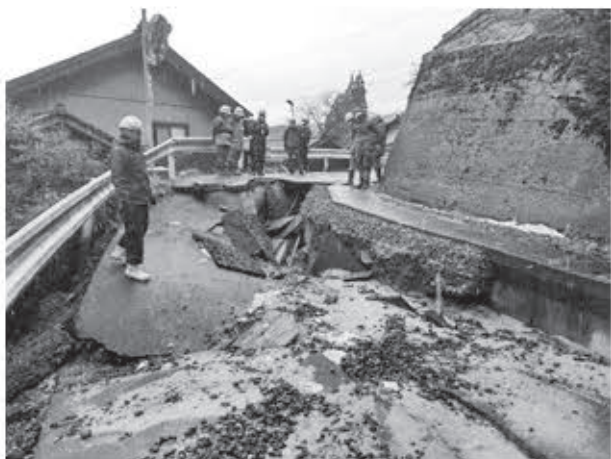
志賀町・配水管の損傷（提供：横浜市水道局）
