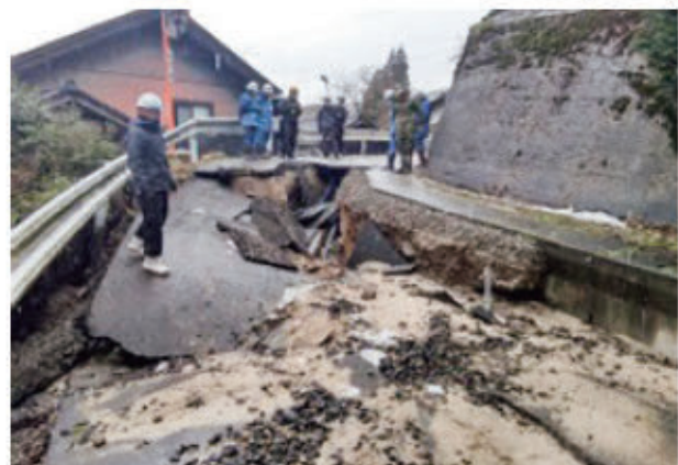
志賀町・配水管の損傷（提供：横浜市水道局）
